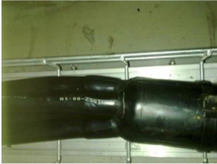
Abbildung 7-1: Risse im Schrumpfschlauch des Mittelspannungskabels.
