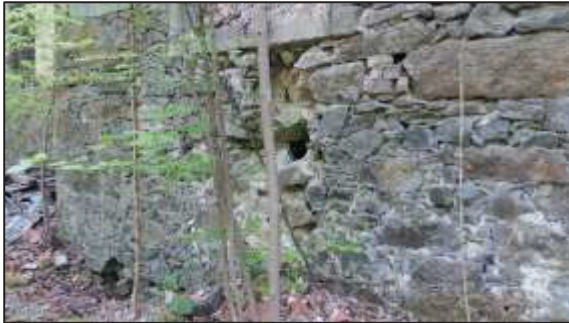
Foto 3: Mauerausbrüche und Spalten
