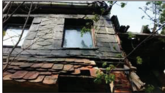
Foto 2: Lose Dachziegel und Schindeln am Gebäude
