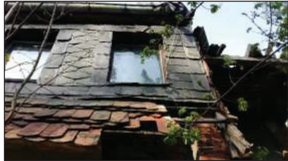
Foto 2: Lose Dachziegel und Schindeln am Gebäude
