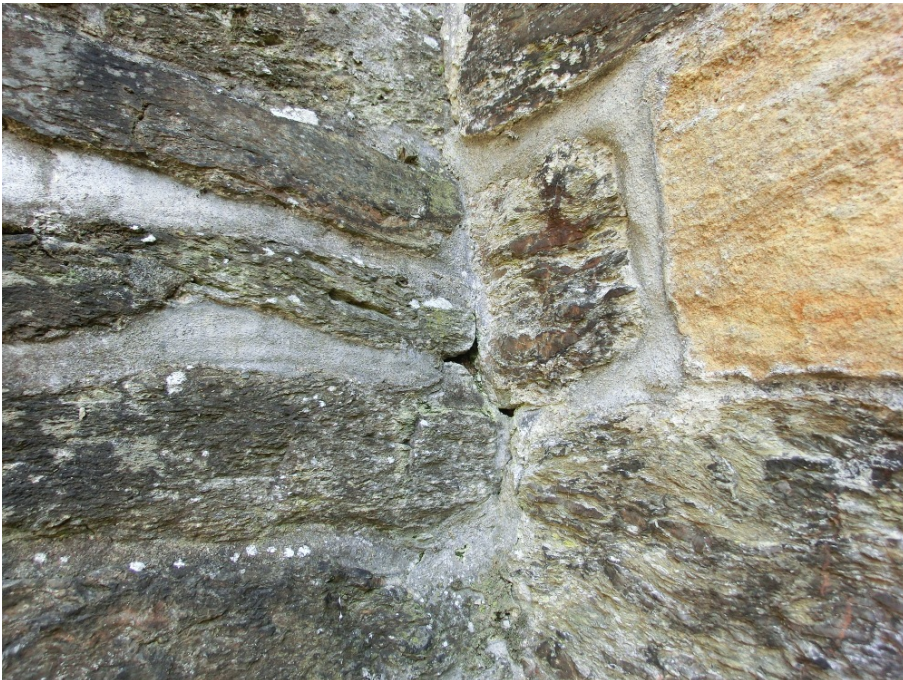
Abbildung 4: Bauwerk 3, Spalt in äußerer Stützmauer
