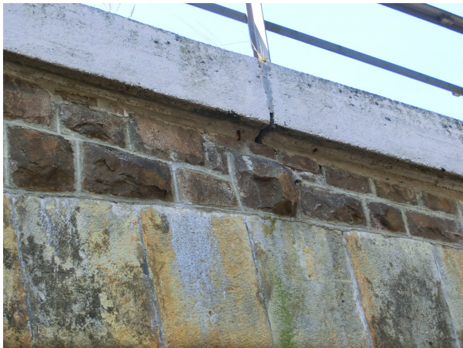
Abbildung 20: Bauwerk 11, Fugen oberhalb des Gewölbes
