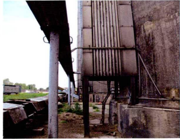
Abbildung 9: Stützentrasse Eit und Förderbänder
