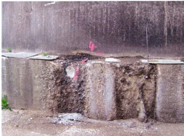
Abbildung 22: Austritt Silagesaft Sockel Silo 5
