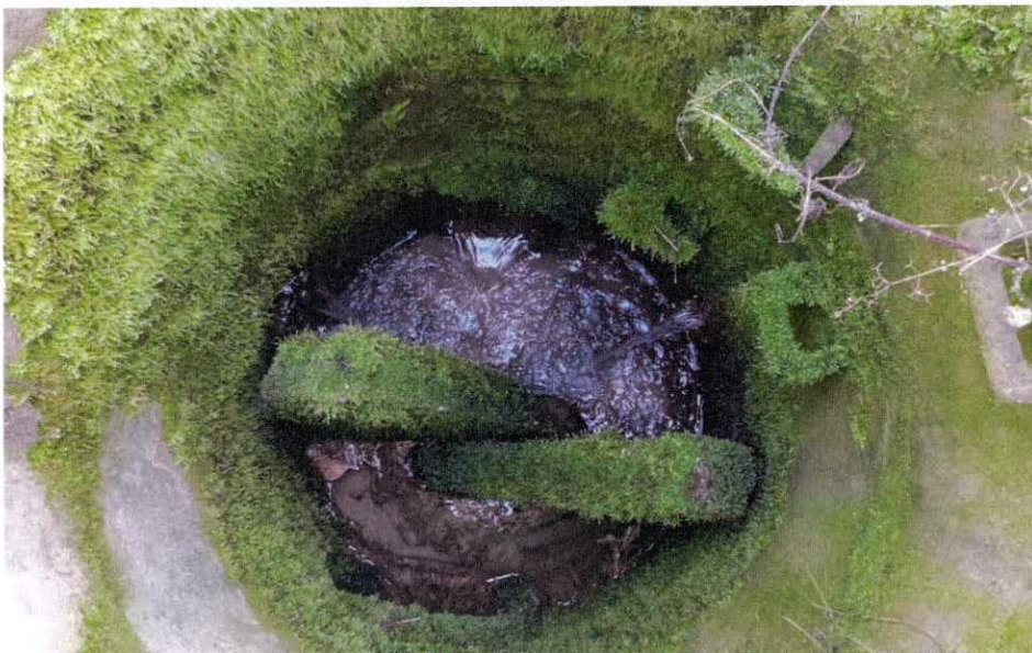
Foto 2: offener Schacht in der Ackerflur mit erkennbaren Drainagemündungen
