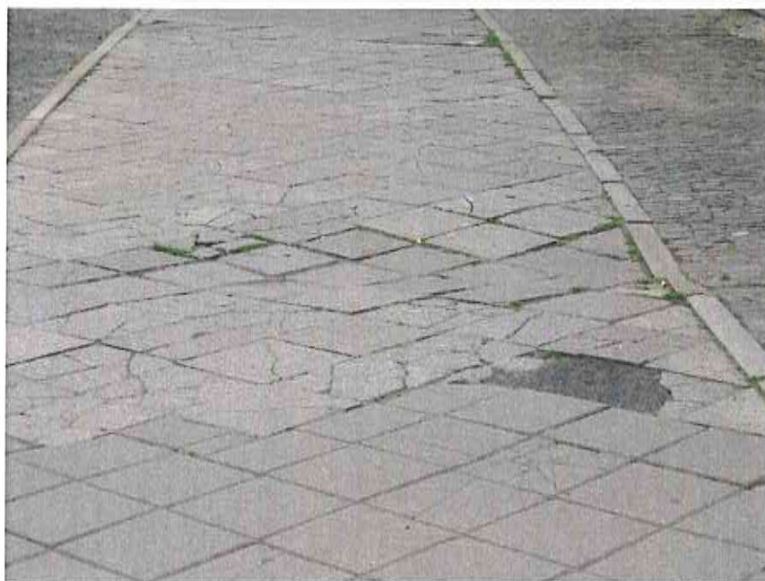
Abbildung 8: Gehweg mit schadhafter Befestigung
