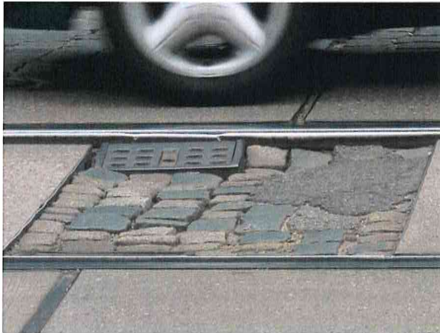
Abbildung 5: Gleisbereich mit schadhafter Gleiseindeckung
