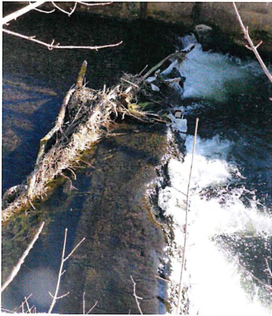
Foto 5: Querriegel aus Beton mit vorgelagerter Metallbefestigung
