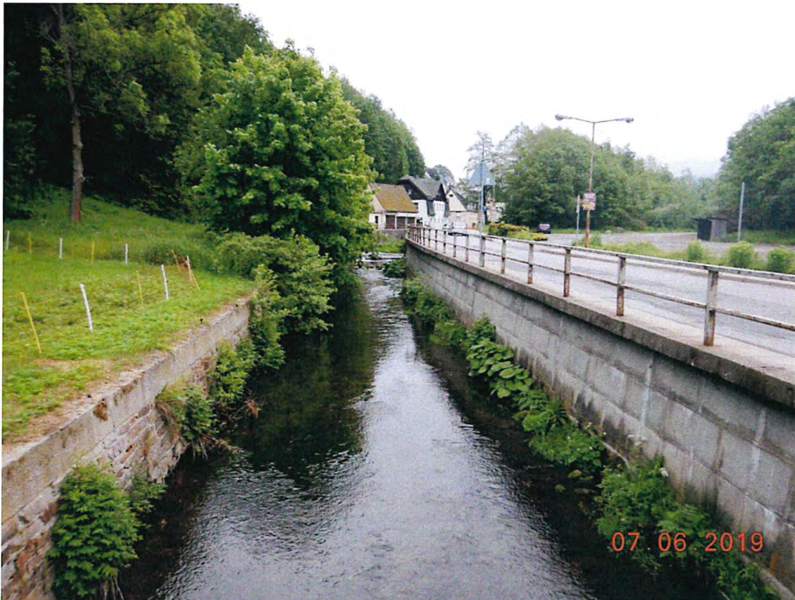
Foto 3: Blick stromaufwärts mit dem vorhandenen BW 6, der herabzusetzenden Stützmauer (rechts) und der zu errichtenden Uferböschung im Zuge des Wehrrückbaus (links)
