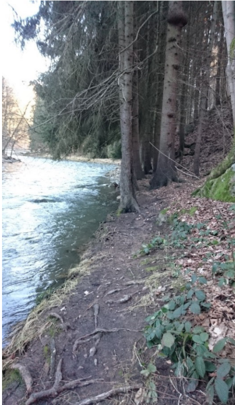
Foto 2: zerstörter Wanderweg und zerstörte Böschungsbefestigung in Schadensbereich 4
