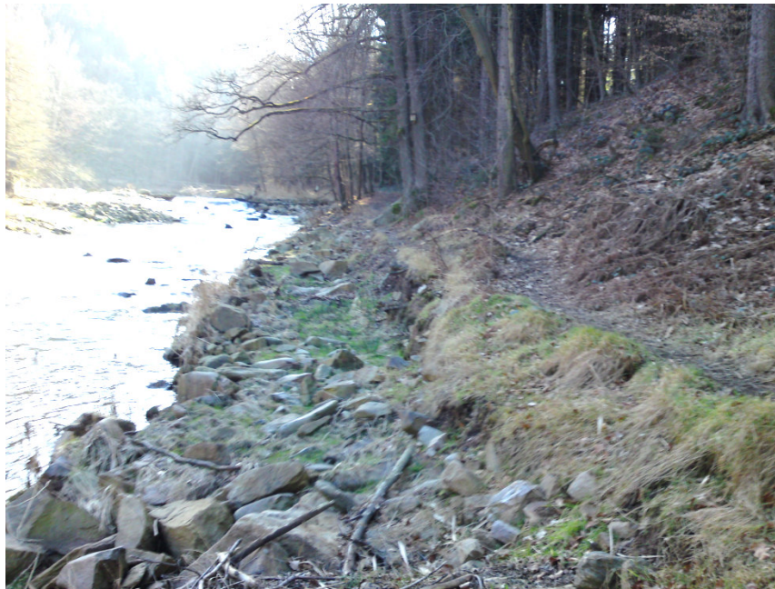
Foto 6: zerstörter Wanderweg/zerstörte Böschungsbefestigung in Schadensbereich 8
