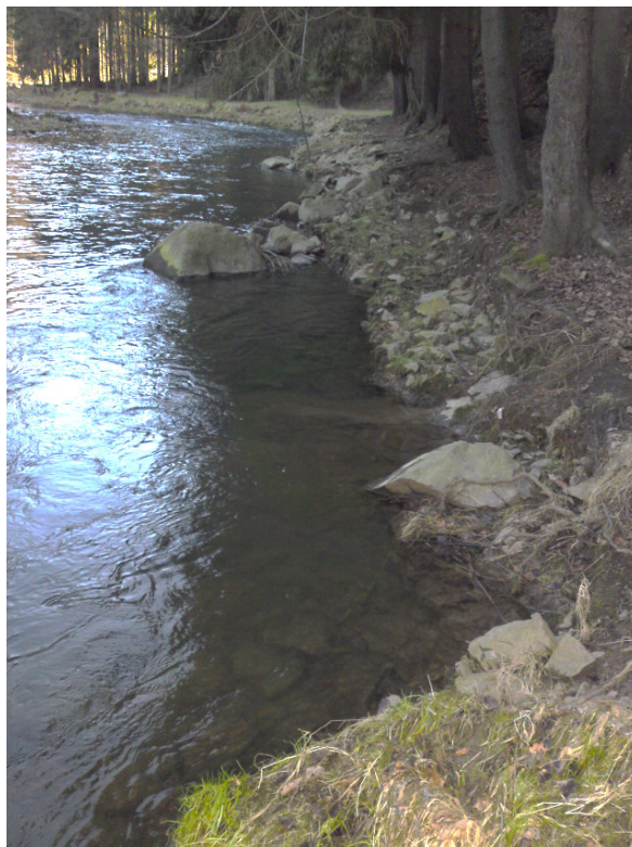
Foto 1: zerstörter Wanderweg und zerstörte Böschungsbefestigung in Schadensbereich 3
