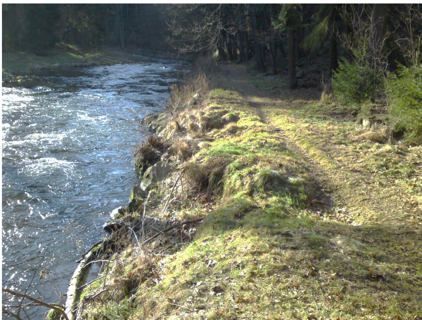
Foto 5: geschädigte Böschungsbefestigung/geschädigter Wanderweg in Schadensbereich 7
