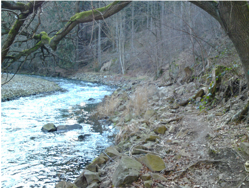
Foto 4: zerstörter Wanderweg/zerstörte Böschungsbefestigung in Schadensbereich 6
