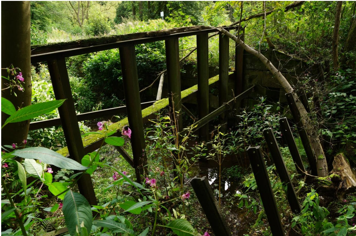
Abbildung 9: Verfallene Wehranlage nahe der Mündung
