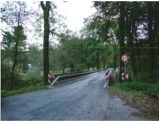
Foto 15: Brücke S 223 über die Flöha an der Papierfabrik Wernsdorf mit Blick in Richtung Osten
