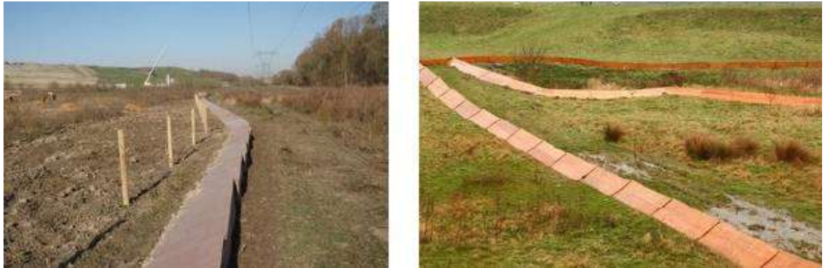
Abbildung 5 : Gerät installiert im Abfalllagerungszentrum von SITA Nord nach LEWARDE (59) (Quelle : Biotope)
