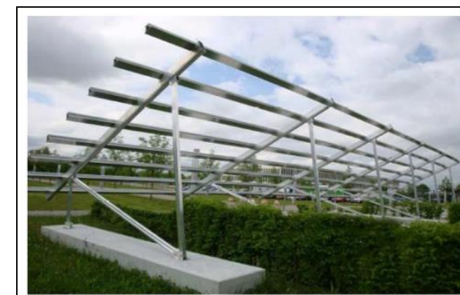
Figure 13 : Photographie d'une structure support métallique sur fondation en longrines
