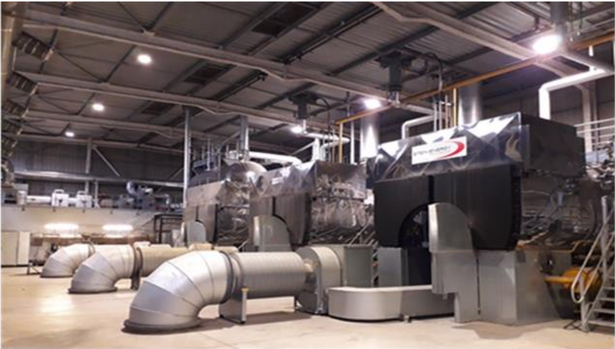
Photographie des chaudières à gaz dans le local DPX
