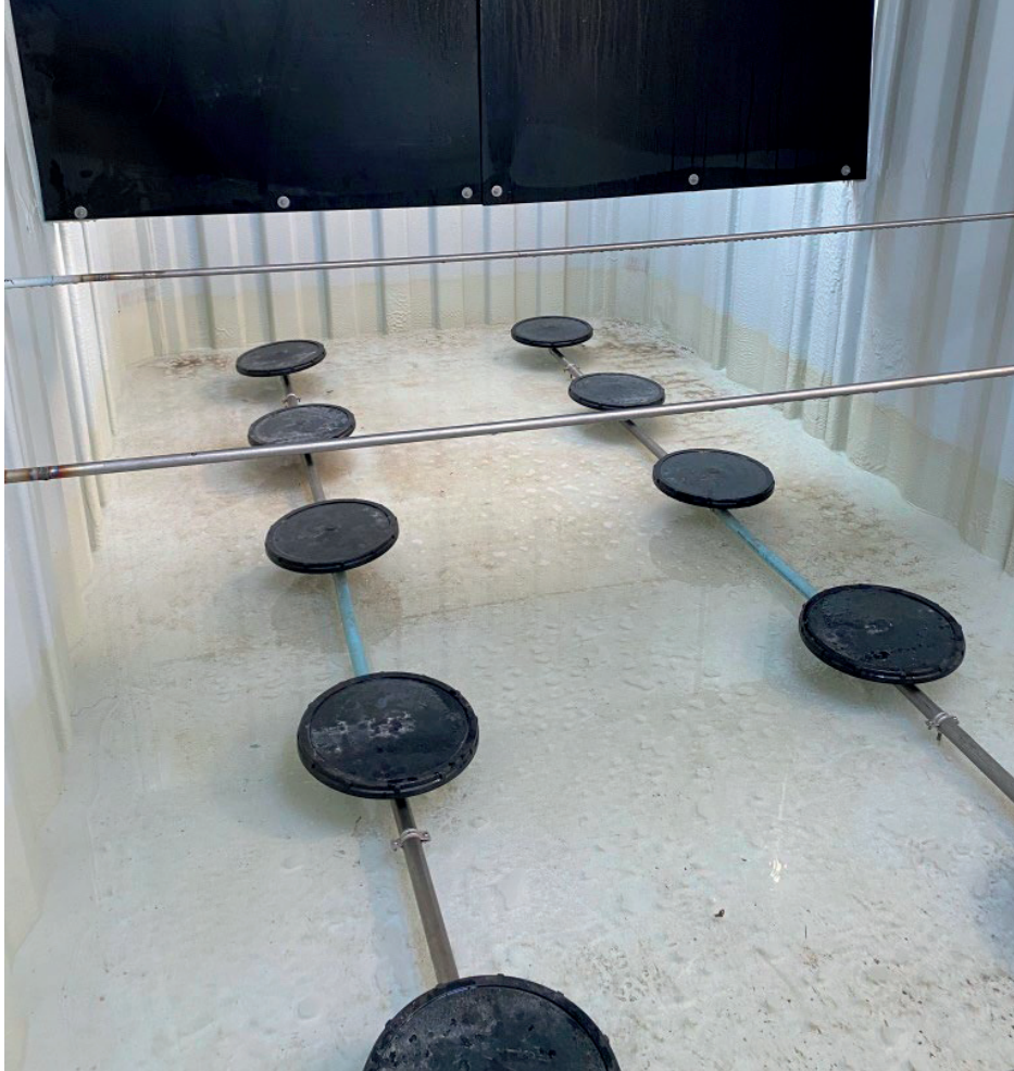
Abbildung 4: Membranscheibenbelüfter im Inneren des Behälters
