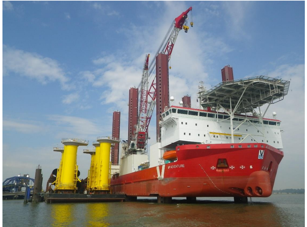
Abbildung 3-9 Installationsfahrzeug während der Positionierung. Hubbeine beim Absenken. Lastkahn mit Monopiles und Übergangsstücken auf Steuerbordseite.
