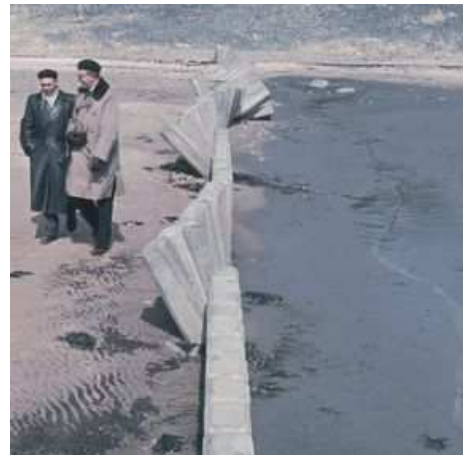
Abb. 16 - zerstörte Betonpfahlbuhne vor der Kurklinik (vor dem Bau der Schüttsteinbuhnen)
