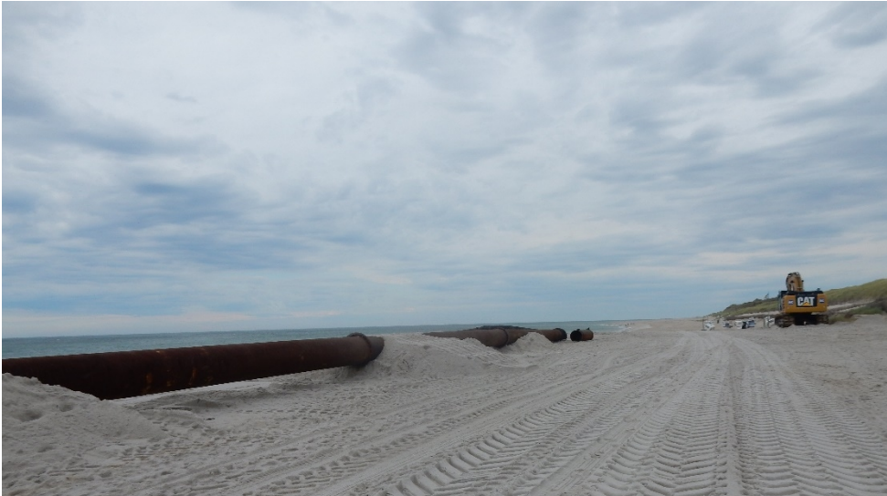
Abbildung 3.11: Beispiel für ein Spülrohr am Strand mit Rampe aus Sand als Querungshilfe (Foto: LKN.SH, Sandaufspülung Sylt 2020)
