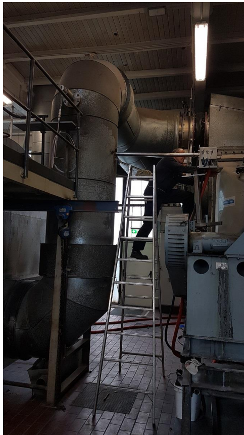
Abbildung 3: Abgasleitung mit Rauchgasentnahme zum Messgerät
