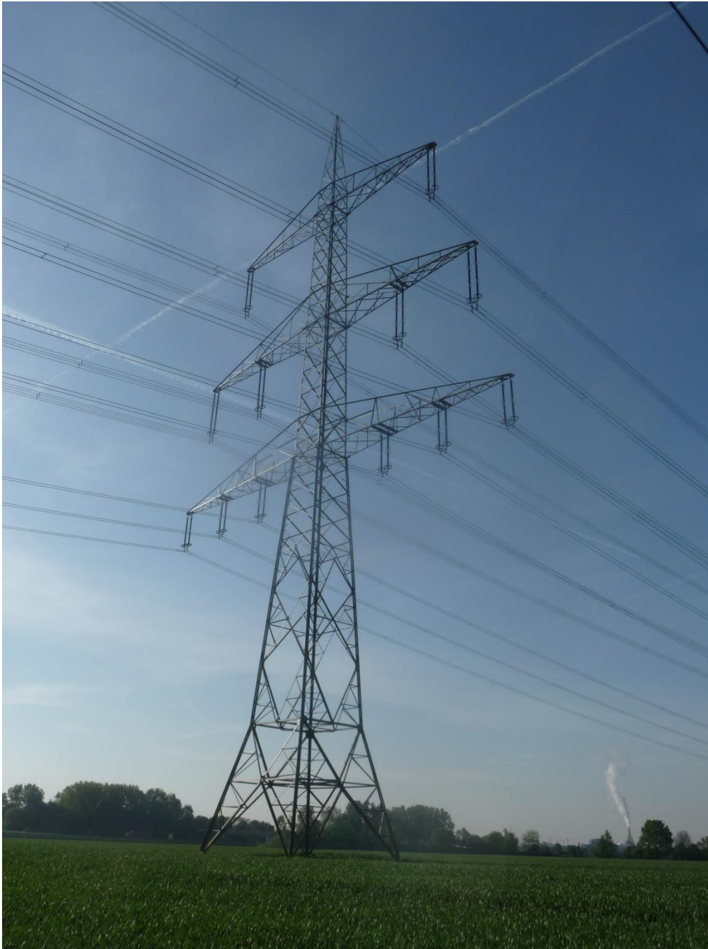
Abbildung 2: Bestandsmast bei Roxheim
