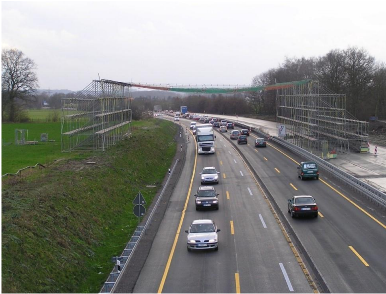
Abbildung 16: Stahlrohrschutzkonstruktion mit Netz über einer Autobahn
