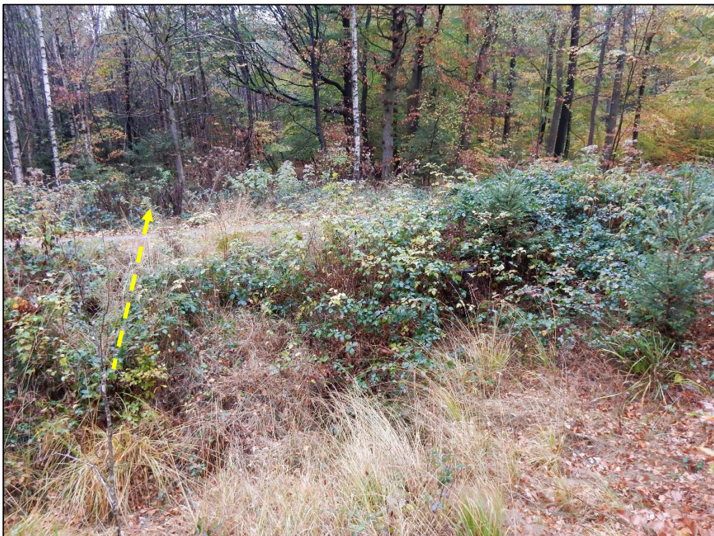
Abbildung 3 - Einlauf der Käsbach Verrohrung (DN 600, Verlauf der Verrohrung: gelb gestrichelt) (Foto: GUTSCHKER-DONGUS 2018)
