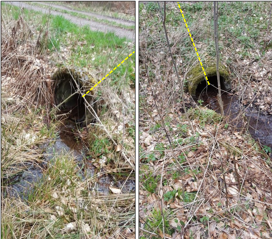
Abbildung 2: Detailansicht Querung 1 mit bestehender Verrohrung unterhalb des Forstweges (DN 600, gelb gestrichelt) (Fotos: GAIA mbh)
