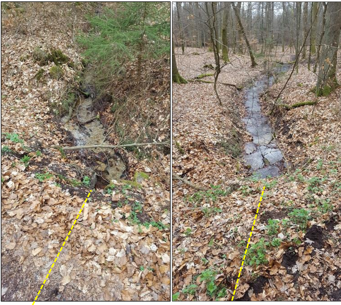
Abbildung 5: Wenig naturnaher Bachverlauf des Quellbachs mit bestehender Verrohrung DN 300 (gelb gestrichelt) angrenzend zum vorhandenen Forstweg (Fotos: GAIA mbH)
