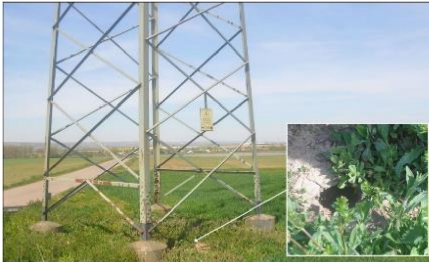
Abbildung 20: Mast Nr. 66 (Blick nach Norden) mit Nager-Bauten am 15.04.2020
