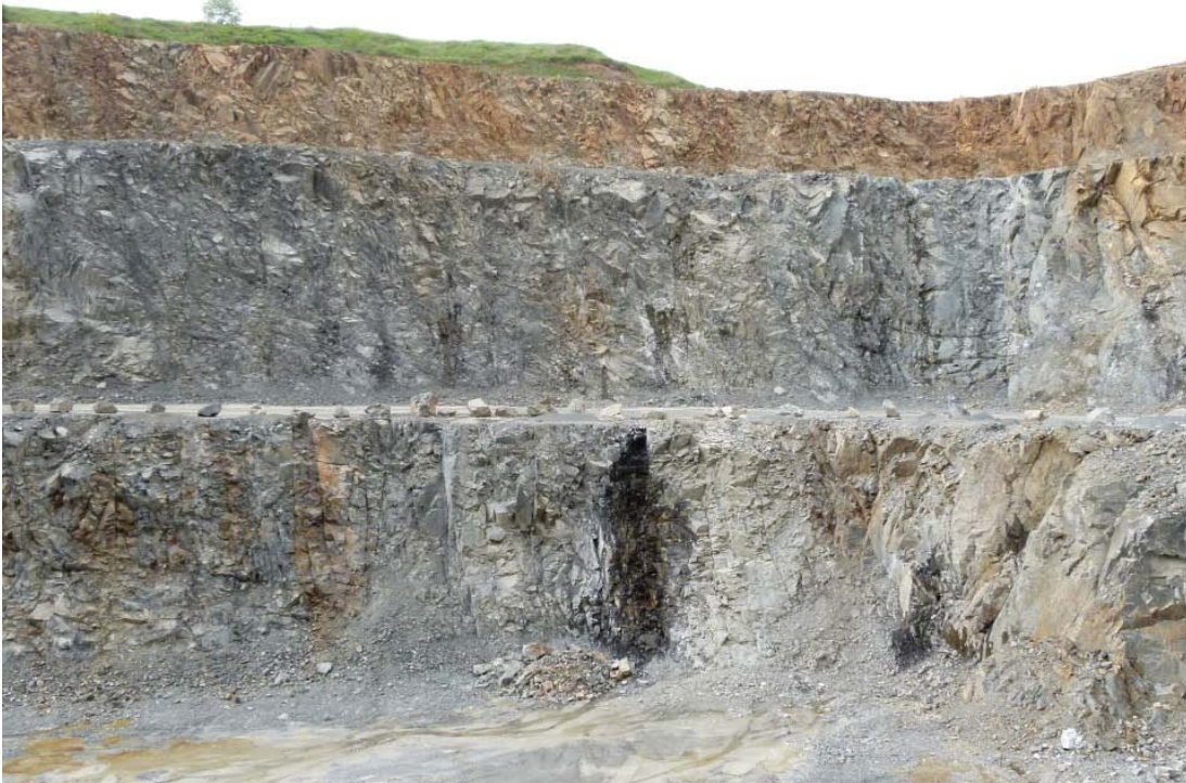
Abbildung 1-28: Vernässungsstellen an der NE-Wand; Blickrichtung NE
