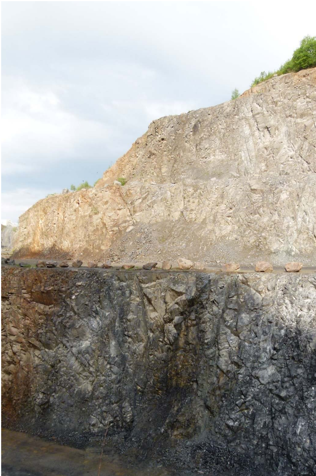
Abbildung 1-30: Vernässungsstelle an der NW-Wand, Blickrichtung NW
