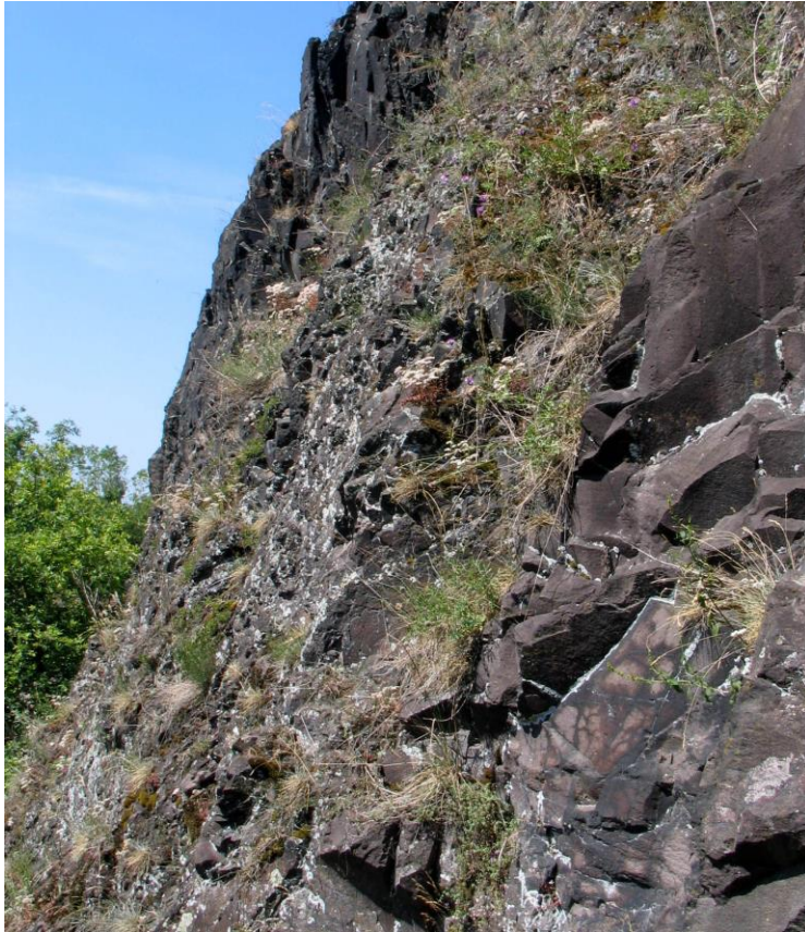
Abbildung 29: Felshangabschnitt mit einer Neigung von ca. 70°
