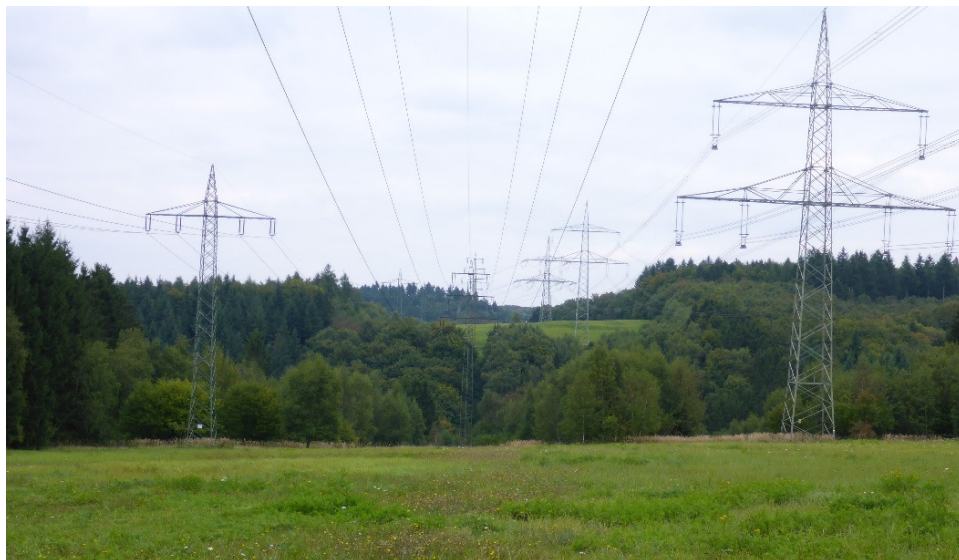
links 110 kV- Bahnstromleitung, Mitte Bl. 0100, rechts 380 kV-Leitung (Amprion)
