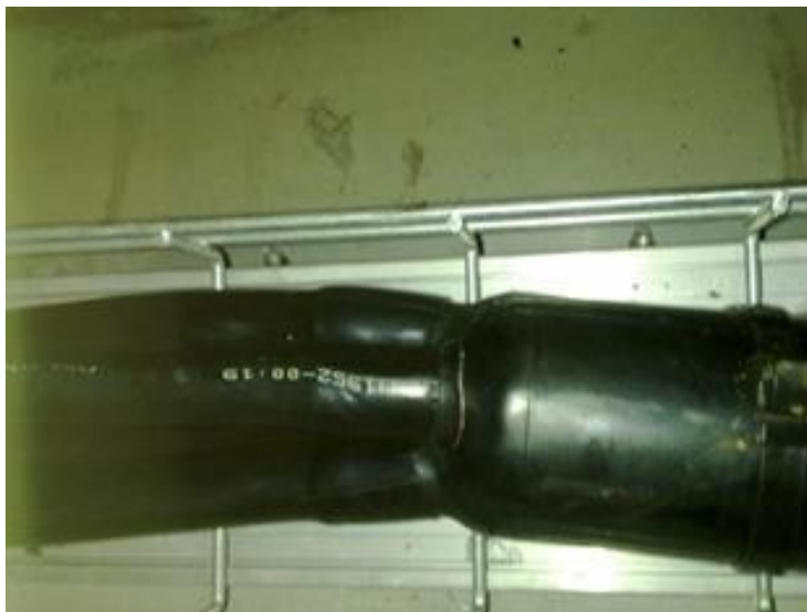
Abbildung 7-1: Risse im Schrumpfschlauch des Mittelspannungskabels.
