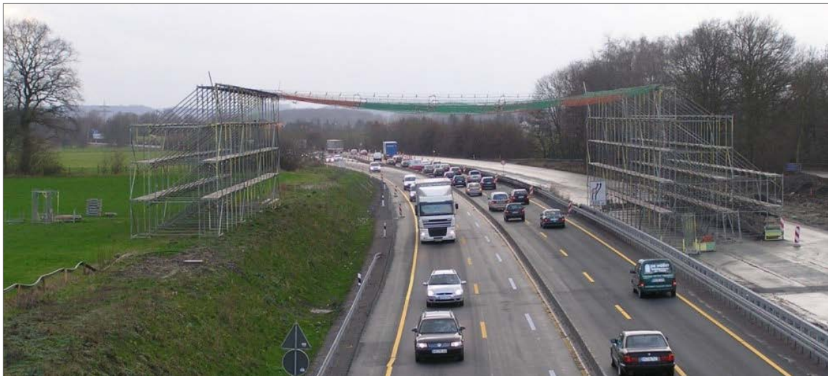
Abbildung 4 Stahlrohrschutzkonstruktion mit Netz über einer Autobahn
