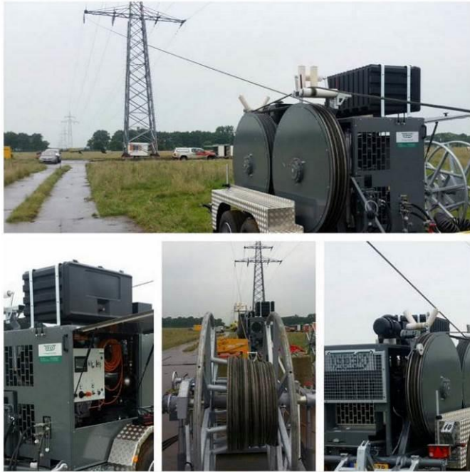
Abbildung 7: Beispielfoto einer Zugmaschine mit Kabeltrommel
