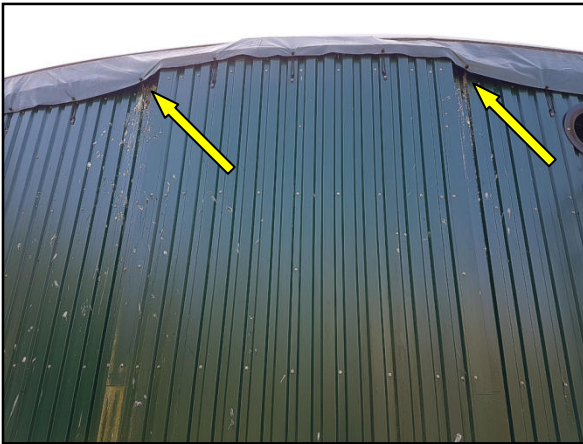
Foto 1: Starenbruten (Pfeile) an der Biogasanlage unter der Abdeckung eines Gärbehälters (11.4.2020)
