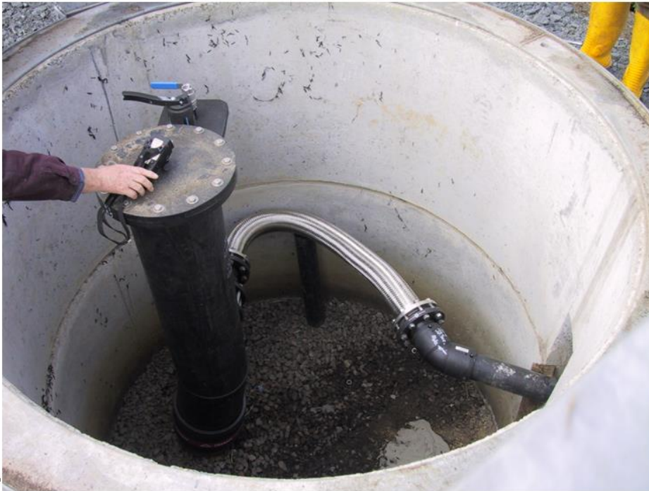
Abbildung 3.14 beispielhafte Ansicht Gasbrunnen
