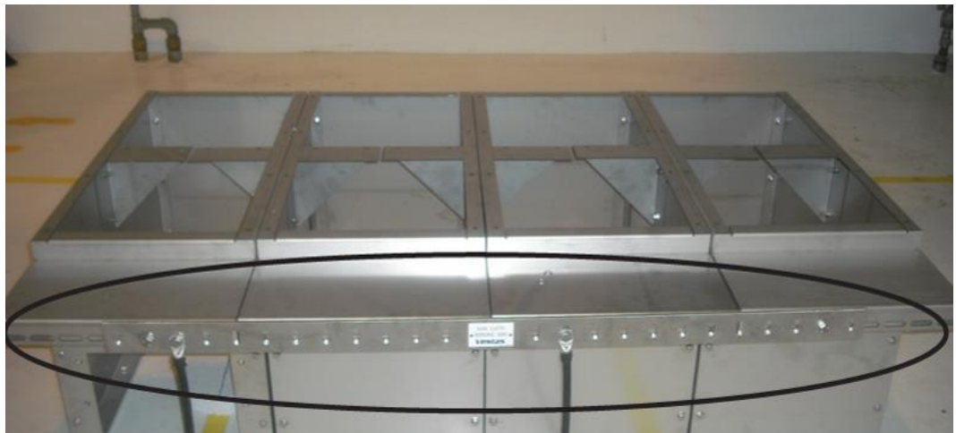
Abbildung 2-2: Auf der Rückseite eines Grundrahmens mit vier Konsolen montierte Haupterdungsschiene.
