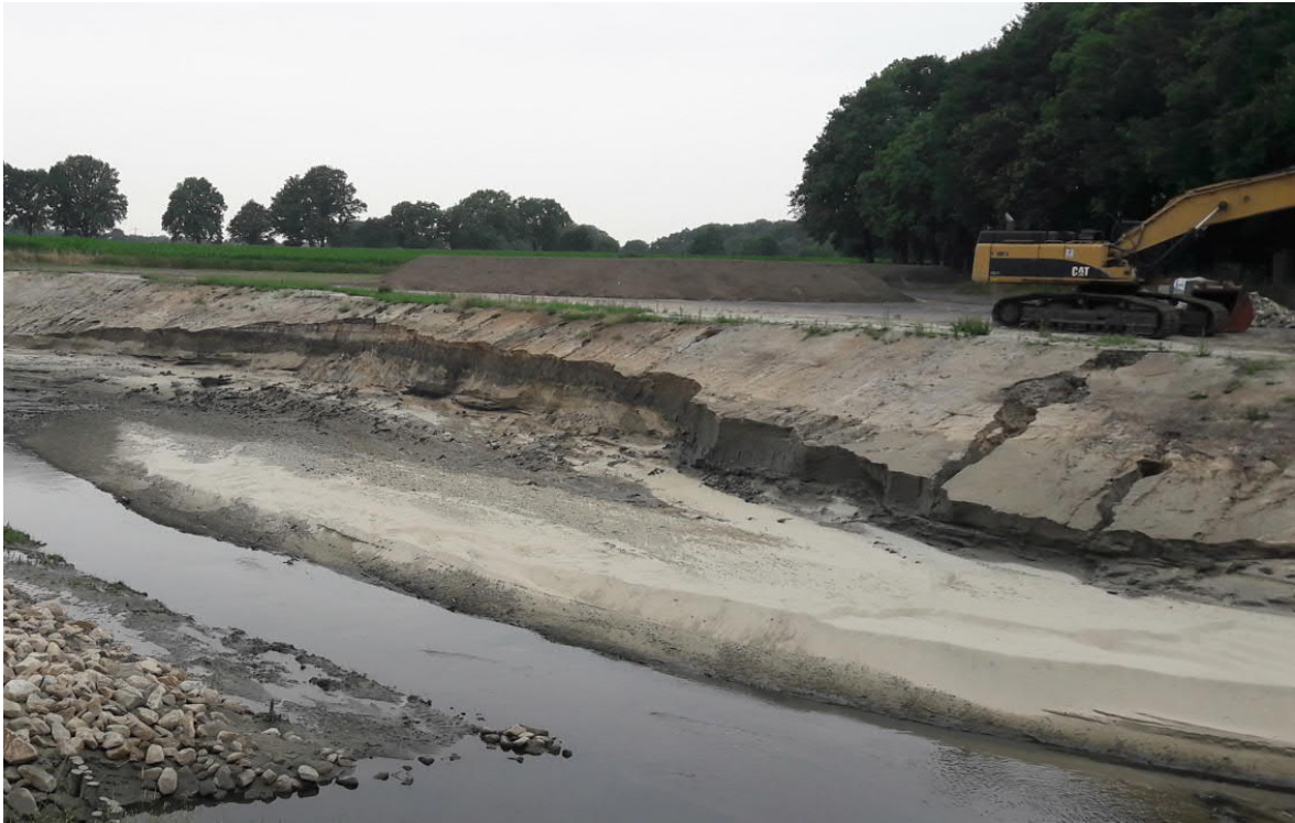
Abbildung 16: Böschungsabbrüche und Grabenerosion an Rohböschungen
