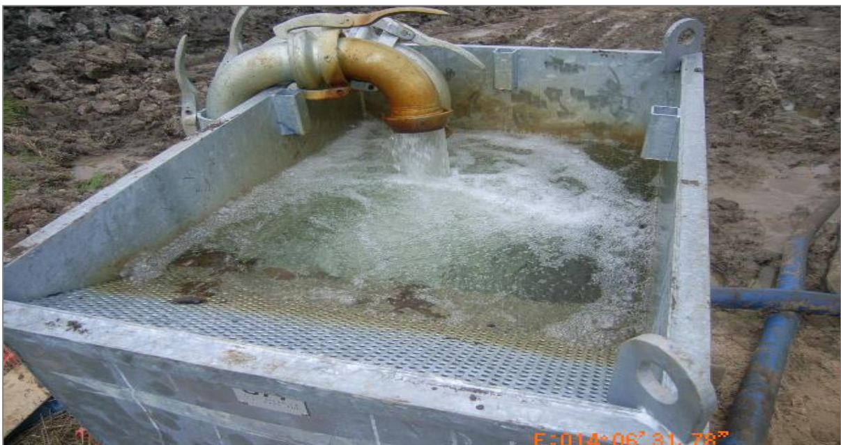
Abbildung 3: Beispiel eines Klär- und Absetzbeckens
