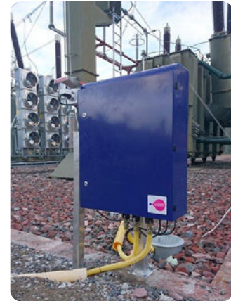
SIPP™ Node installiert an der Ölauffangwanne des Transformators
