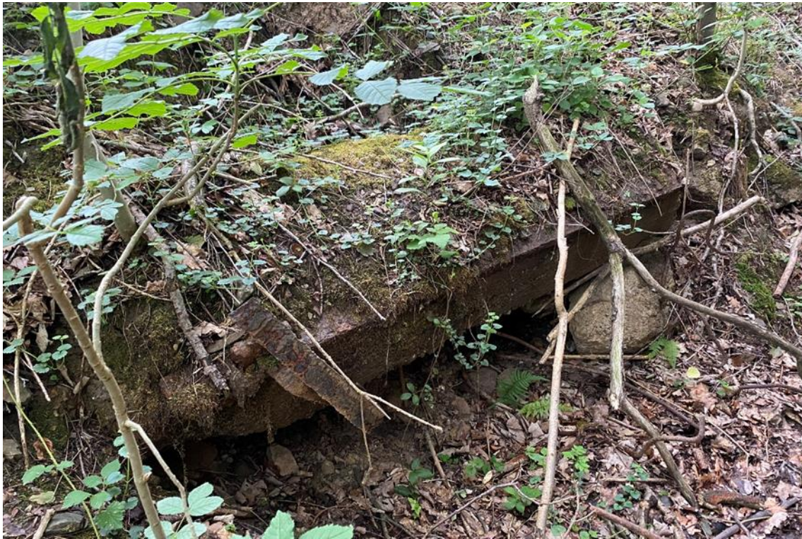
Abb. 10: Verlagerter Türsturz mit Stahlträger und Eisenscharnier (Foto: Karin Schramme).
