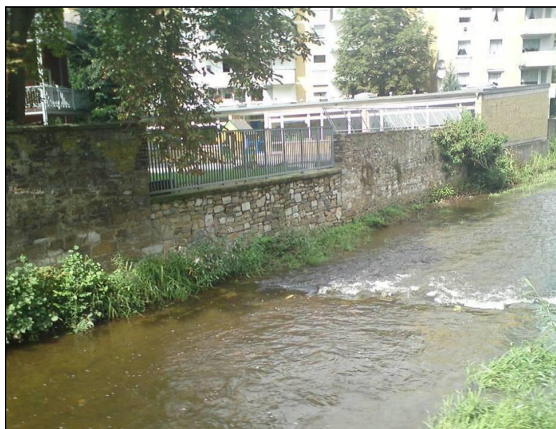
Bild 6.6: Ufertiefpunkt. links – km 3,146
