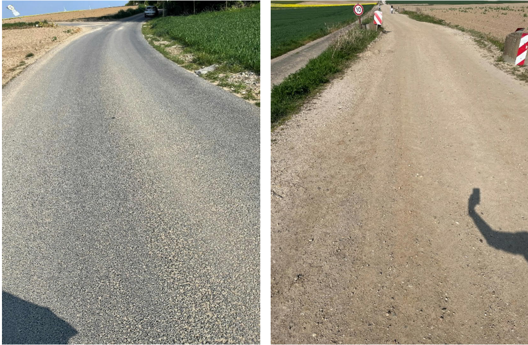
Abbildung 8: Zustand der Zufahrt Südost im nördlichen Bereich.
