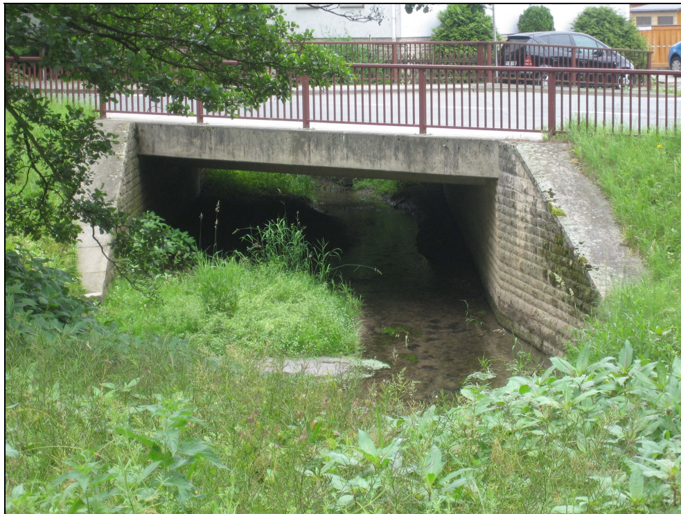
Abb. 8.12 Anlandungen unter Brückenbauwerken
