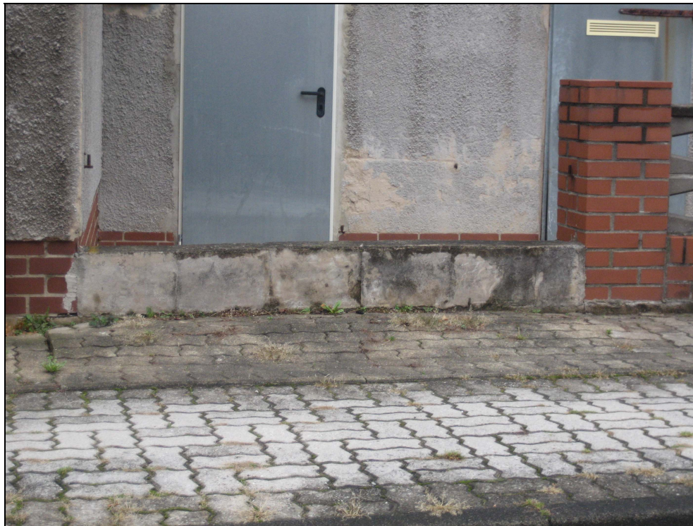
Abb. 3.24 Feste Schutzvorrichtungen im Eingangsbereich (Quelle L+N)
