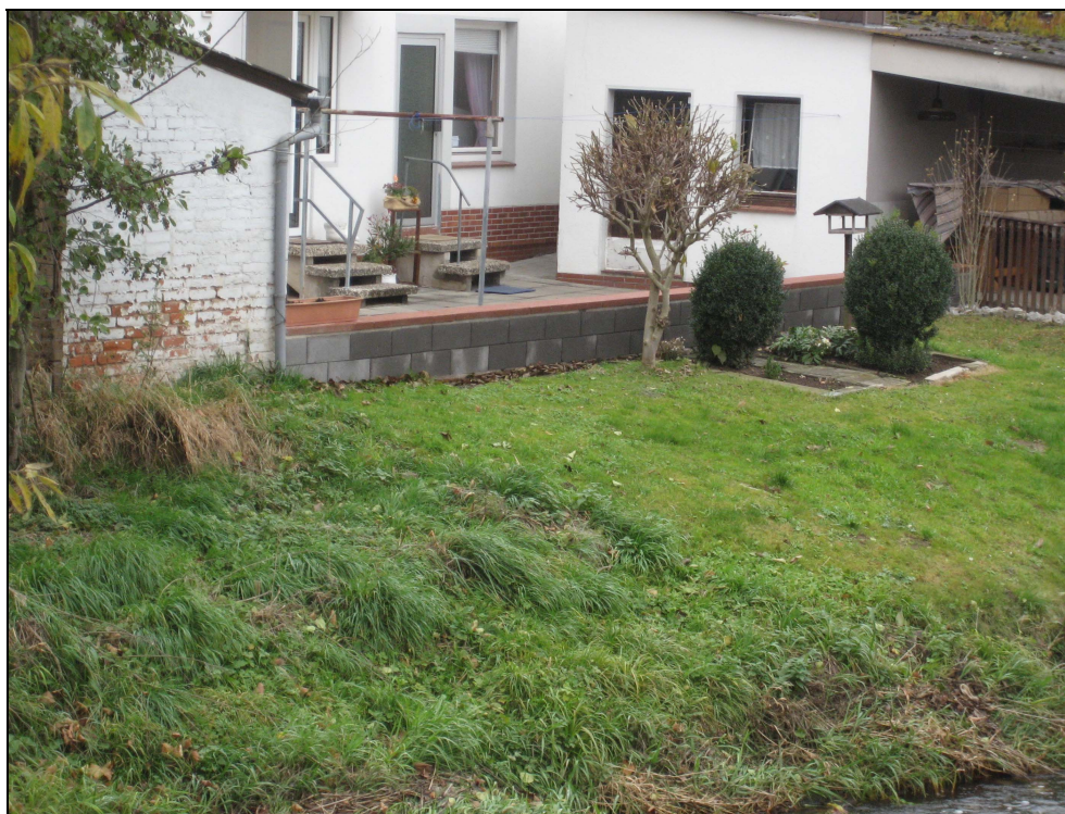
Abb. 1.8 Schutzvorrichtung Mauer (Quelle L+N)
