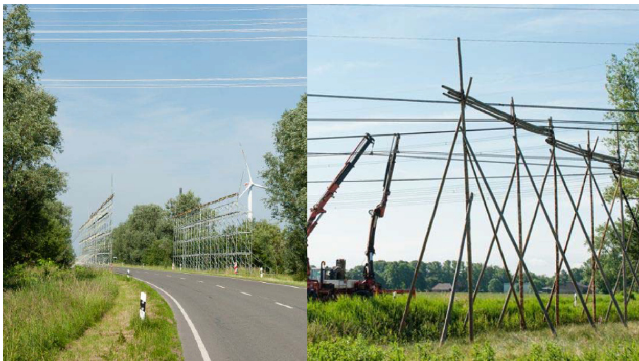
Abbildung 32: Beispiele für Schutzgerüste aus Stahl bzw. Holz
