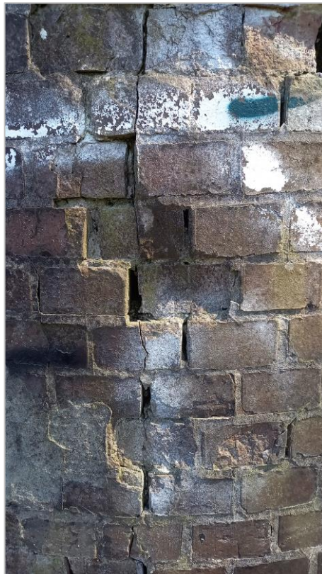
Abb. 15: Rissbildungen und Spalten im Mauerwerk der Brücken-Widerlager
