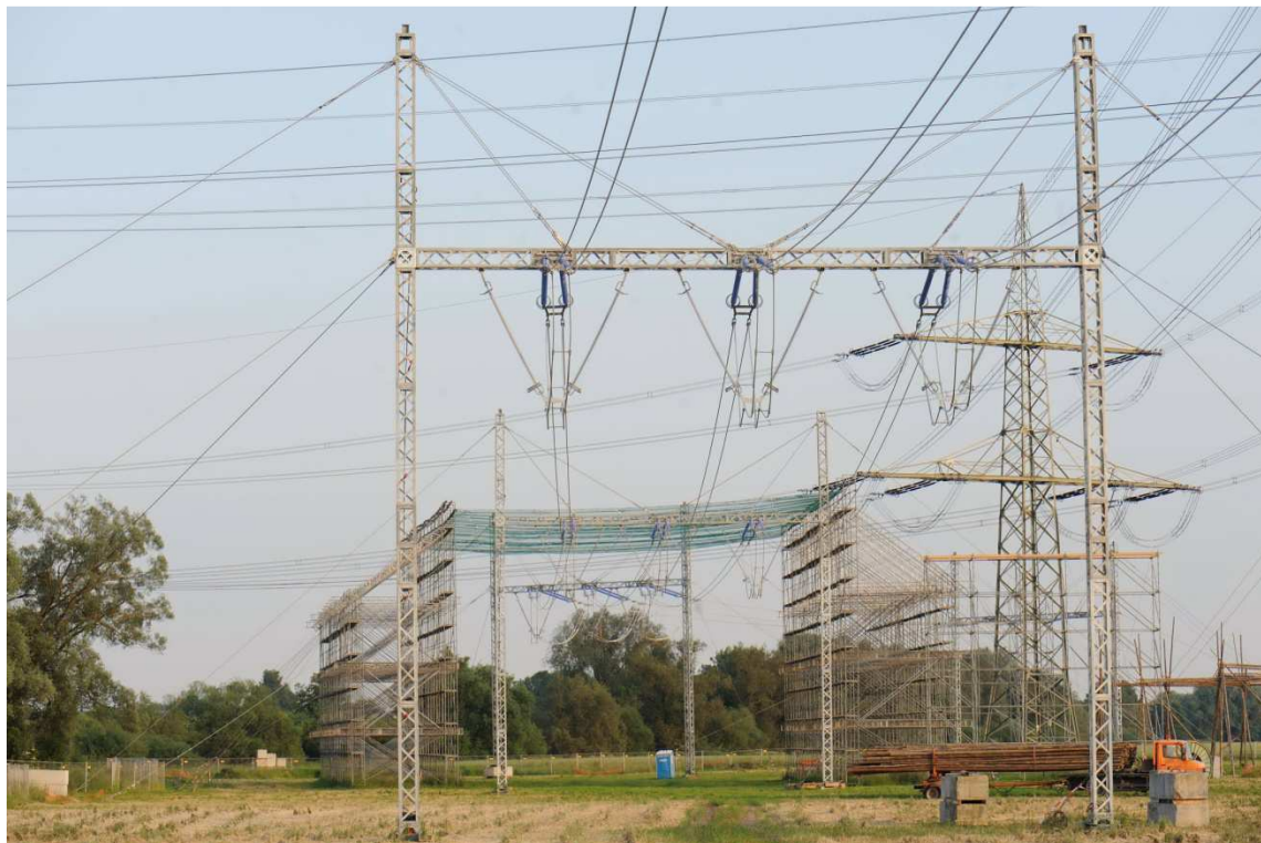
Abbildung 30: 380-kV-Freileitungsprovisorium für ein System, mit errichtetem Schutzgerüst
