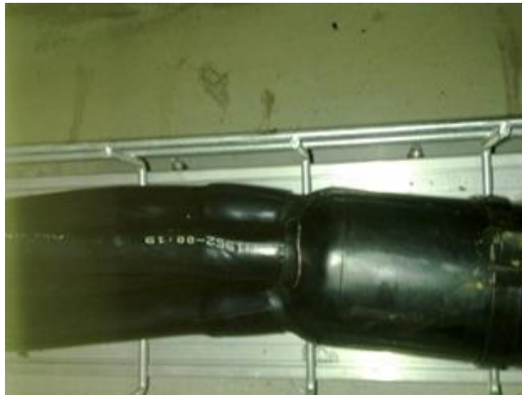
Abbildung 7-1: Risse im Schrumpfschlauch des Mittelspannungskabels.
