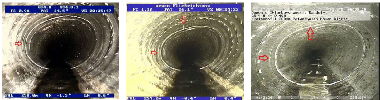
Abbildung 9: S 408, Station 258 m, Rissbildung, links 2016, Mitte 2019, rechts 2020
