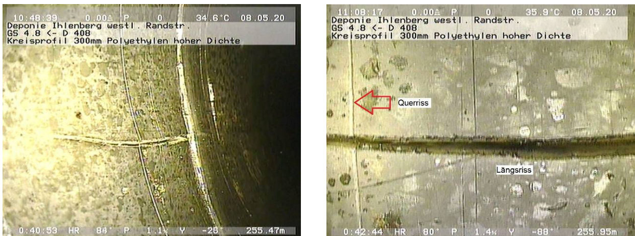
Abbildung 10: Sickerwasserleitung 408, Detail Risse
