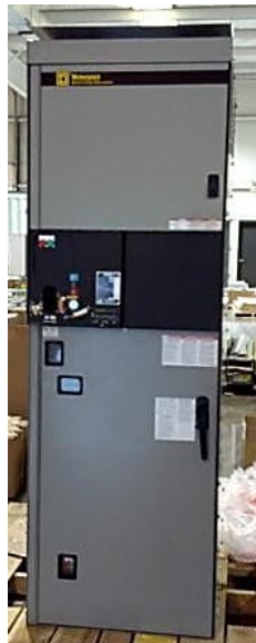
Abbildung 5: Stator Switch Cabinet (Stator-Schaltschrank)
