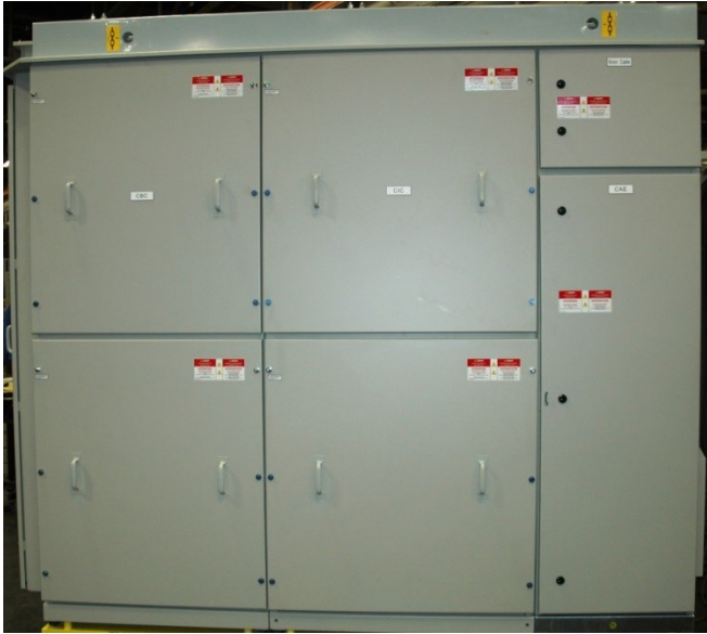
Abbildung 2: Rückansicht des DFIG-Umrichterschrankes (Brücken-, Induktionsspulen-, Wechselstromeingangs- und Rotorkabelschrank)
