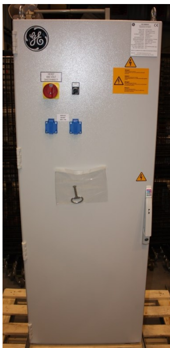
Abbildung 4: Low Voltage Distribution Panel (Niederspannungsverteiltertafel)
