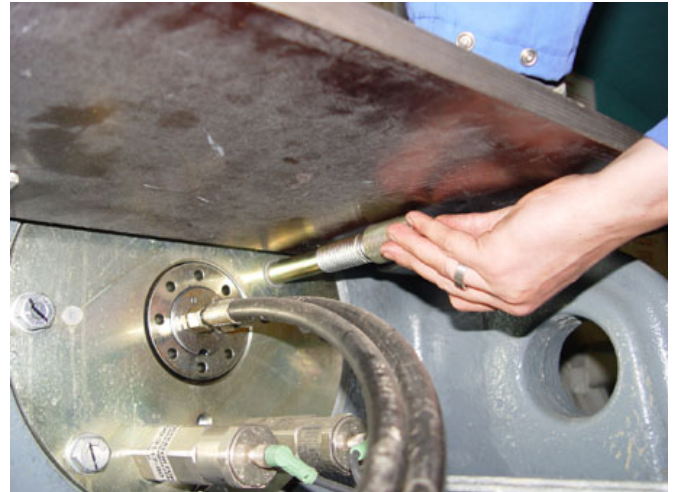
Abbildung 16: Sichern der LSS-Rotorarretierung - 3 MW
