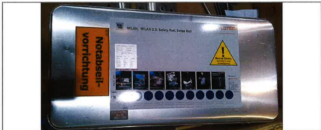
Abb. 3: Notabseilausrüstung in der WEA
