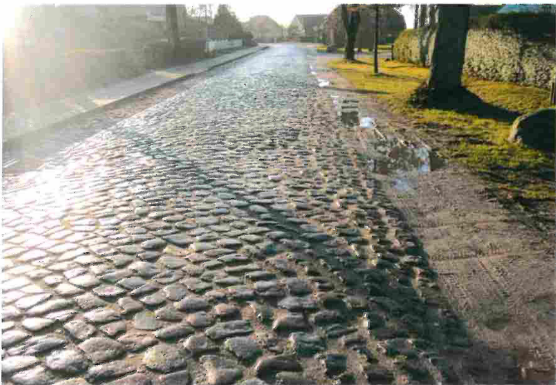
Bild 2: Fahrbahnoberfläche der K 18 OD Warnow Höhe Entnahmestelle 2 - Bankettbereich ausgefahren
