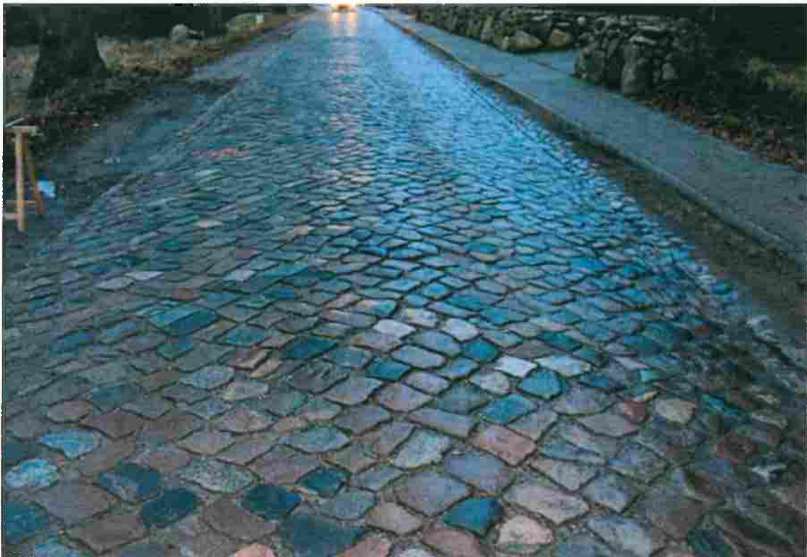
Bild 6: Fahrbahnoberfläche der K 18 OD Warnow Höhe Entnahmestelle 12 -
