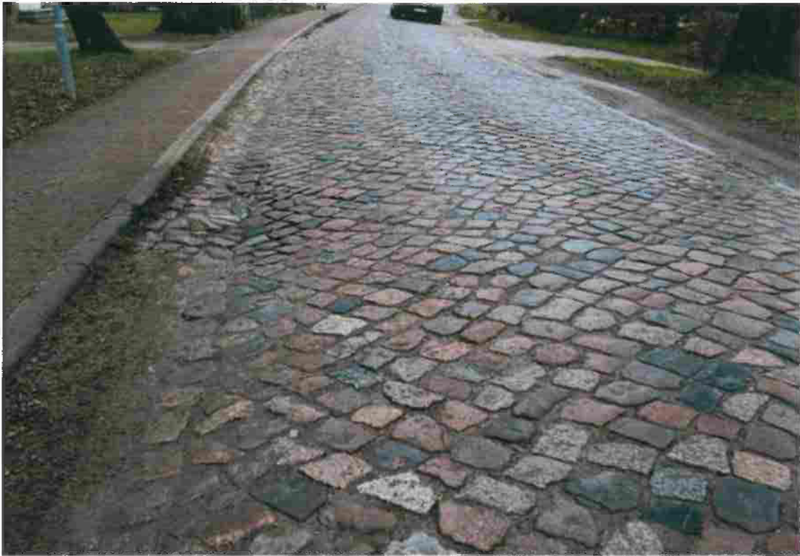
Bild 5: Fahrbahnoberfläche der K 18 OD Warnow zwischen den Entnahmestellen 7 und 8 - Absackungen an den Fahrbahnrandern, rechts wie links
