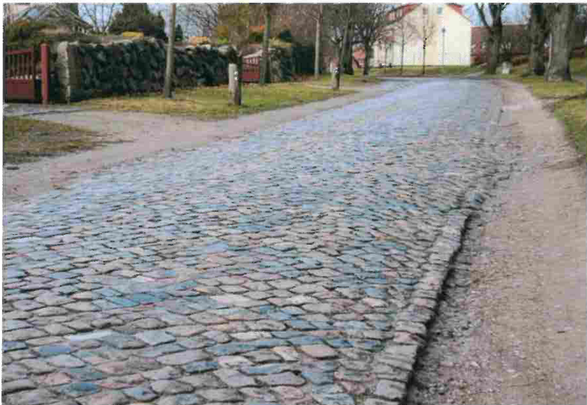
Bild 4: Fahrbahnoberfläche der K 18 OD Warnow zwischen den Entnahmestellen 6 und 7 - Verdrückungen in der Fahrbahn an Ausfahrten
